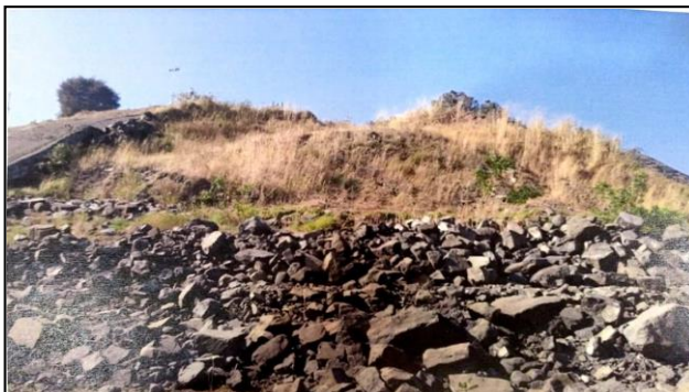
Figure 3. Distressed divide bund (Kapadia 2022)
